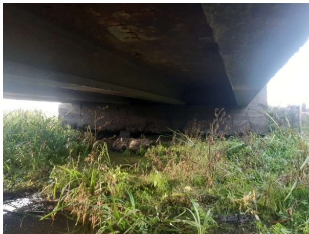
Fot. 88 Spodnia strona płyty z widoczną korozją
