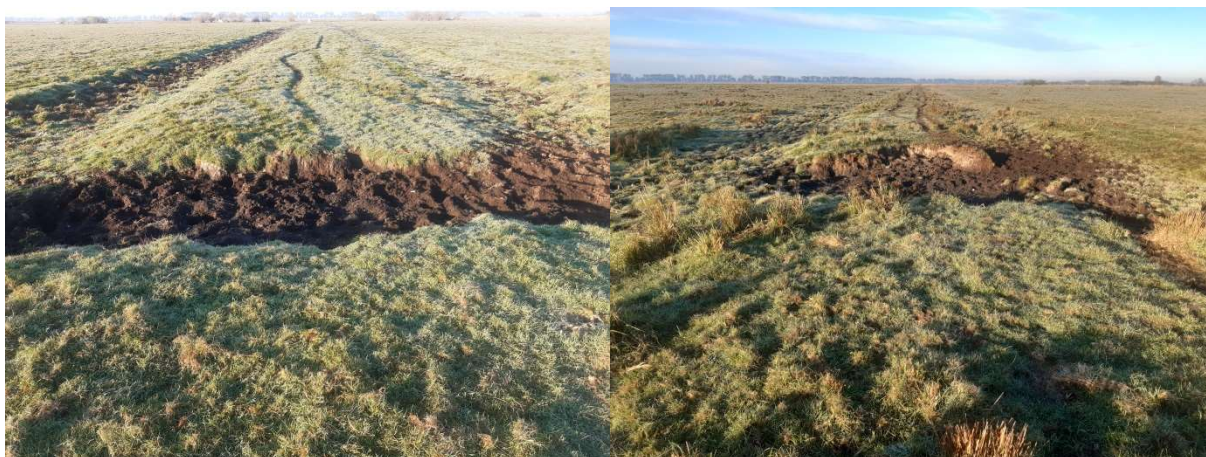
Fot. 46 Przykładowe przerwanie korony na drodze nr 23
