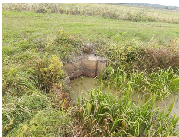
Fot. 18 Niedrożny przepust na drodze nr 12
