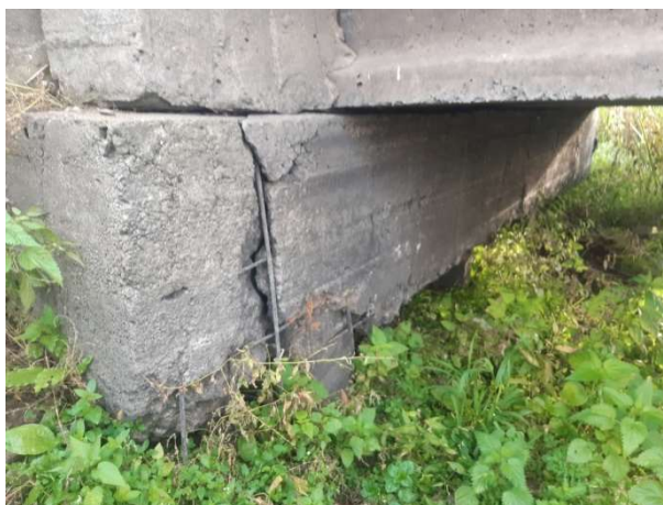
Fot. 85 Pęknięta podpora skrajna
