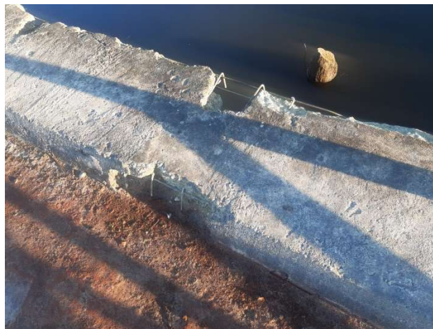
Fot. 168 Ubytki betonu i odsonięte zbrojenie w kapie chodnikowej
