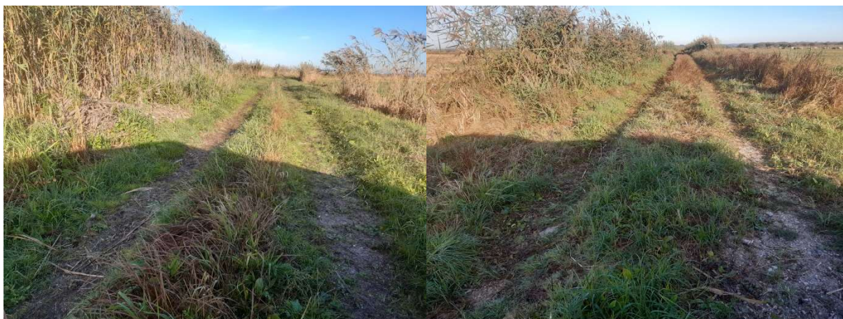
Fot. 53 Droga nr 27 w zadowalającym stanie
