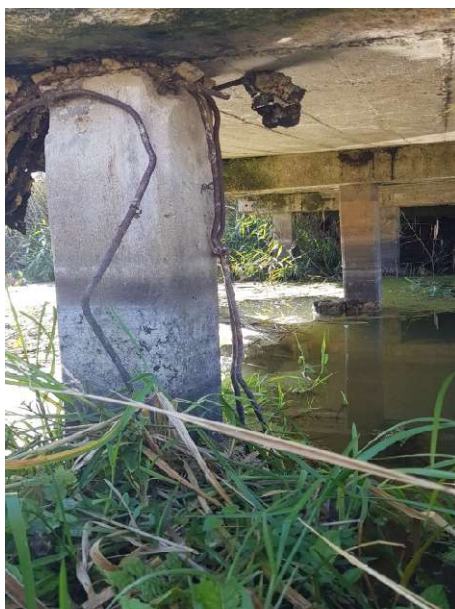
Fot. 144 Brak belki oczepowej
