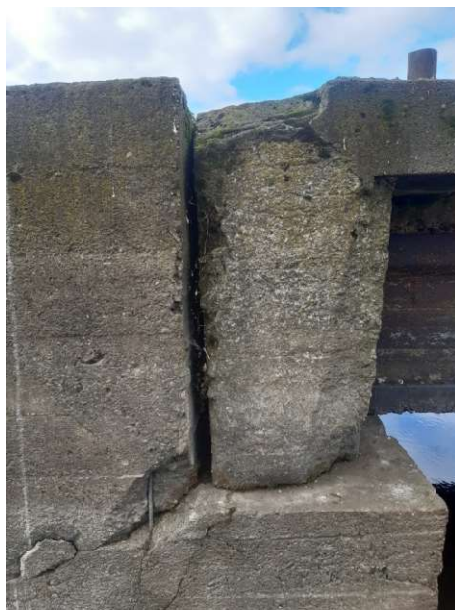
Fot. 69 Widok uszkodzeń belki ocepowej podpory skrajnej
