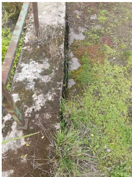
Fot. 151 Szczelina w moście na drodze numer 12
