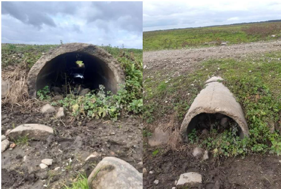
Fot. 22 Stan przepustu na drodze nr 15 (kilometraż 0+550)
