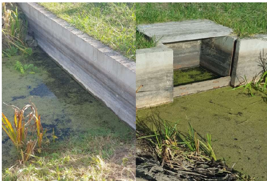
Fot. 11 Niedrożny przepust na drodze nr 6 (kilometraż 3+154)
