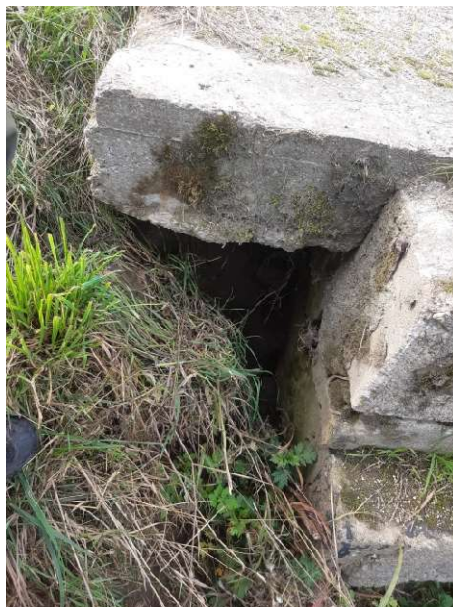
Fot. 154 Podmywanie mostu na drodze numer 13
