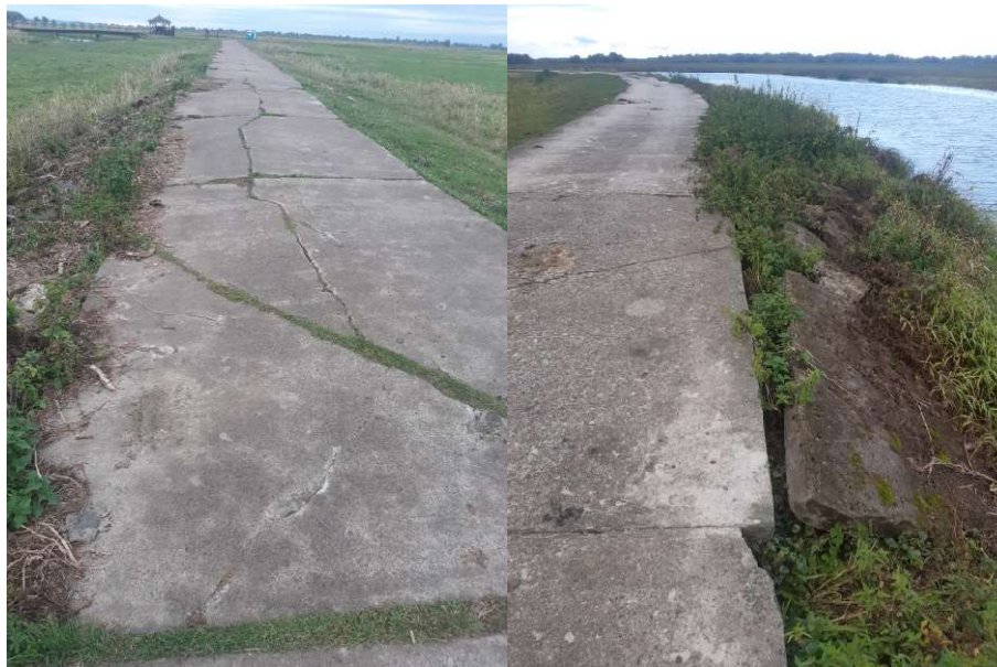
Fot. 34 „Betonka” z uszkodzeniami nawierzchni
