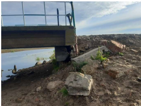
Fot. 76 Uszkodzone skrzydło
