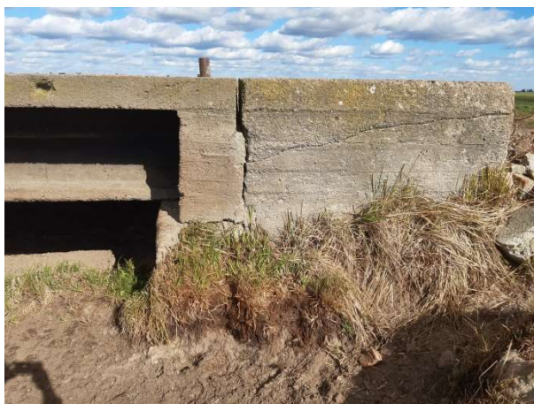
Fot. 164 Spękane skrzydło przyczółka
