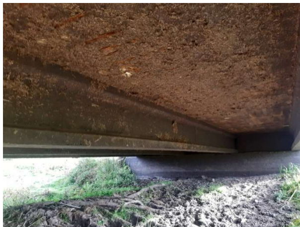
Fot. 94 Spodnia strona płyty z widoczną korozją
