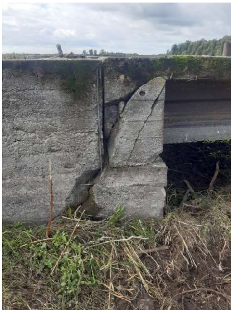
Fot. 126 Widok uszkodzeń belki ocepowej podpory skrajnej
