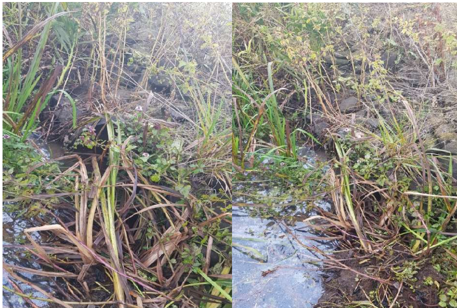
Fot. 13 Niedrożny przepust na drodze nr 9
