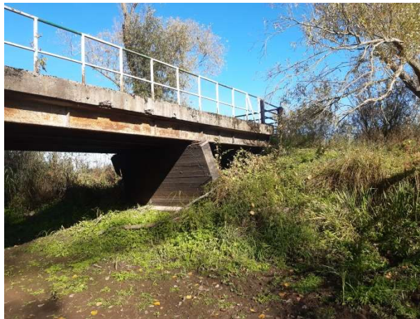
Fot. 132 Uszkodzony filar mostu
