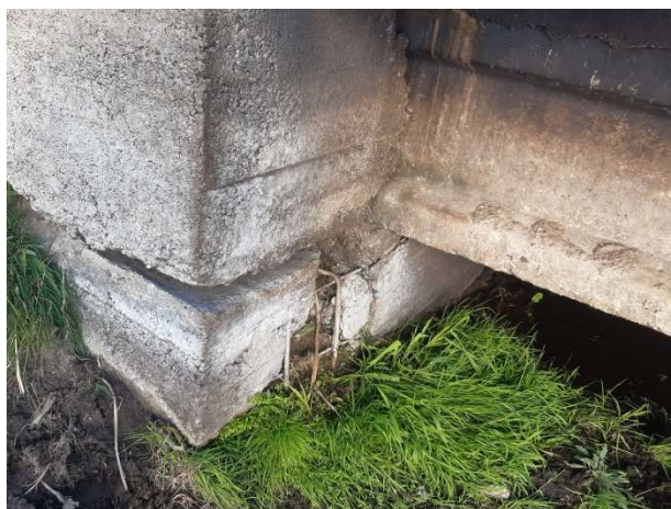
Fot. 162 Uszkodzona podpora skrajna mostu na drodze numer 19(3)
