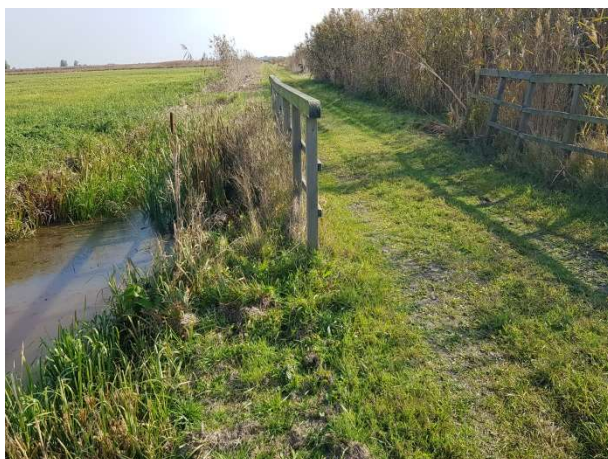
Fot. 15 Niedrożny przepust na drodze nr 10 (kilometraż 1+603)
