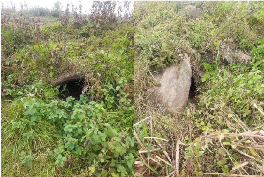
Fot. 23 Stan przepustu na drodze nr 15 (kilometraż 1+126)
