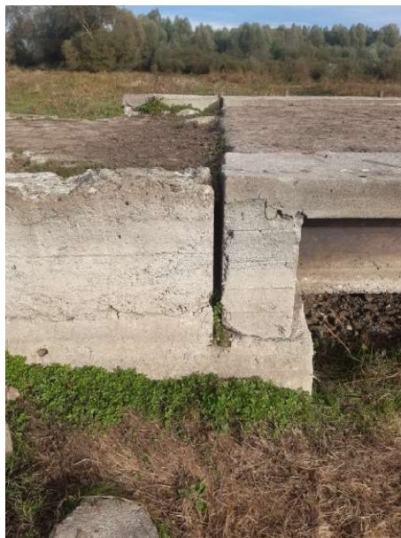
Fot. 92 Szeliny dylatacyjne
