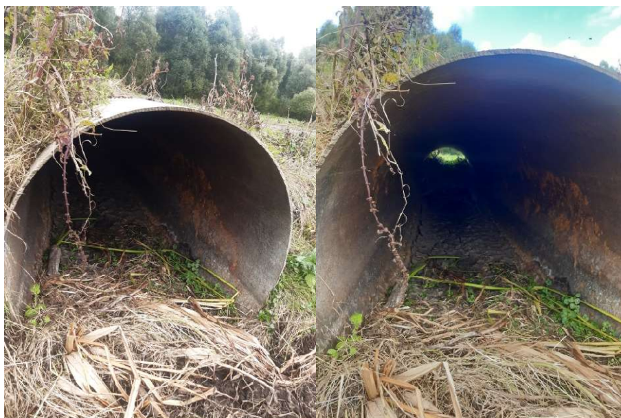
Fot. 26 Stan przepustu na drodze nr 15 (kilometraż 1+699)
