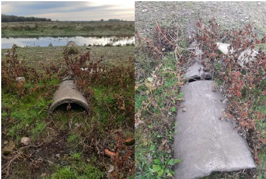
Fot. 28 Stan przepustu na drodze nr 15 (kilometraż 3+324)
