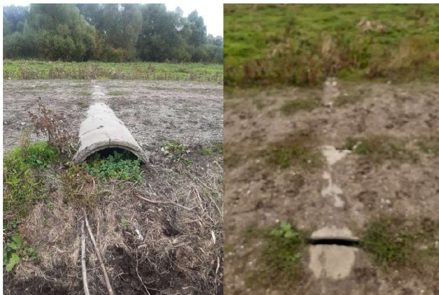
Fot. 25 Stan przepustu na drodze nr 15 (kilometraż 1+436)
