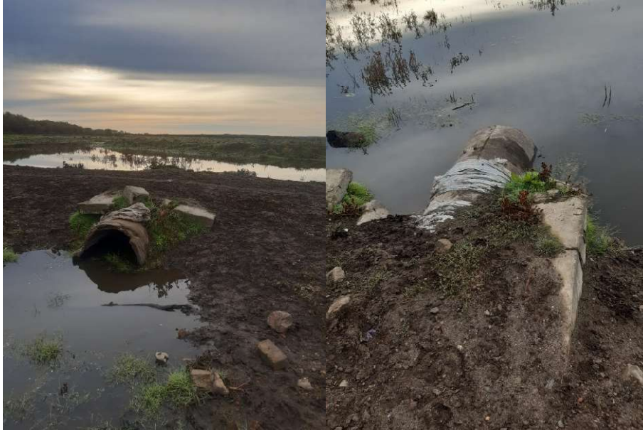
Fot. 27 Stan przepustu na drodze nr 15 (kilometraż 3+253)
