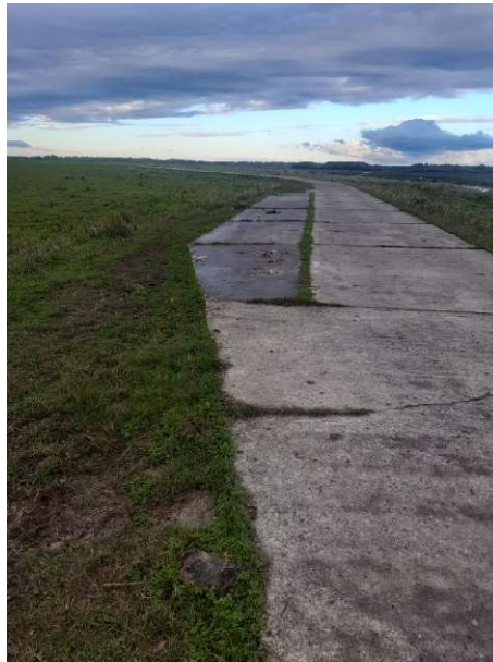
Fot. 33 Mijanka betonowa na drodze nr 16
