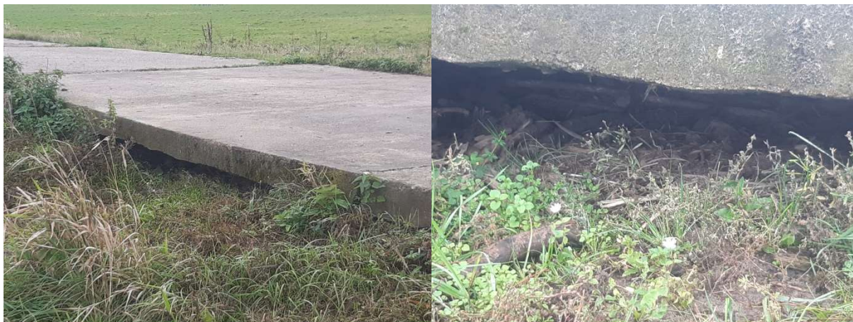
Fot. 35 Podmyta nawierzchnia betonowa na "Betonce"
