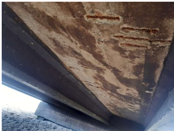
Fot. 165 Spodnia strona płyty z widoczną korozją
