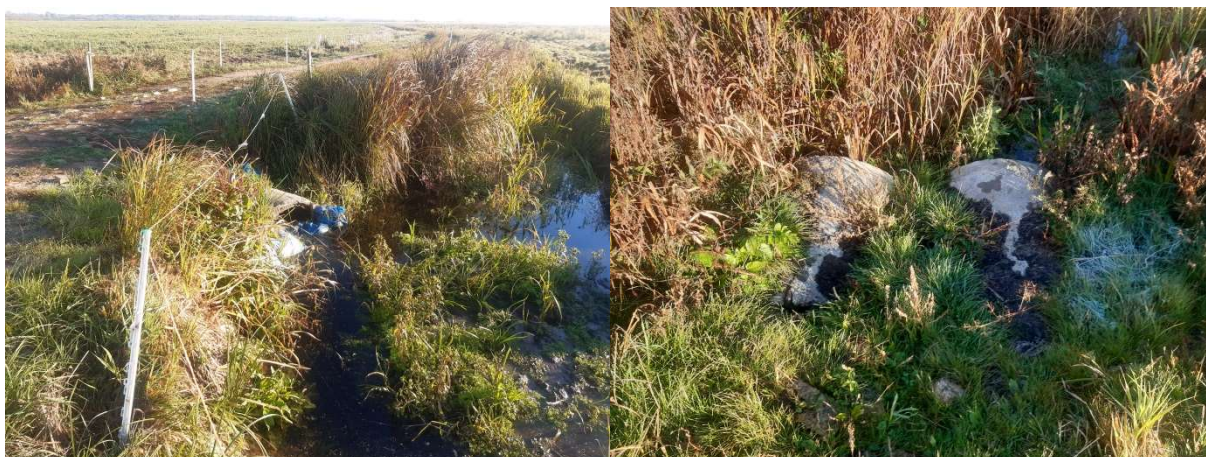
Fot. 47 Przepust częściowo drożny na drodze nr 23 (kilometraż 1+039)
