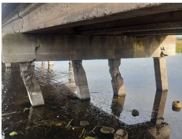
Fot. 75 Brak ciągłości słupów, pęknięty oczep i odchylenie w kierunku osi rzeki
