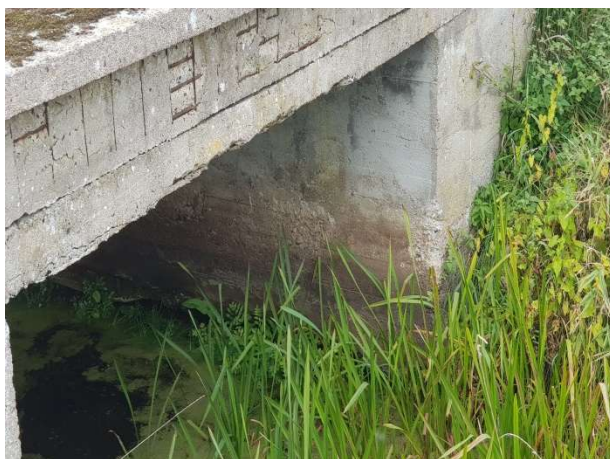
Fot. 138 Erozja betonu na ustroju nośnym
