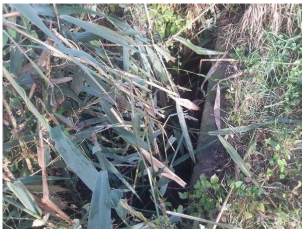
Fot. 83 Ograniczona drożność przepustu okularowego
