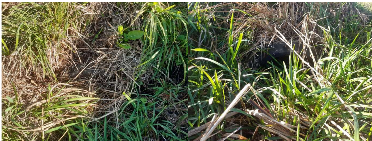
Fot. 52 Niedrożny przepust na drodze nr 26
