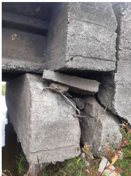
Fot. 64 Widok uszkodzeń belki oczepowej podpory skrajnej
