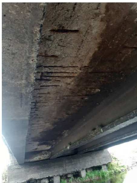
Fot. 72 Spodnia strona płyty z widoczną korozją
