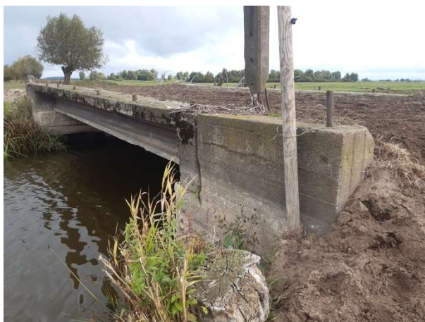
Fot. 122 Widok uszkodzeń belki oczepowej podpory skrajnej
