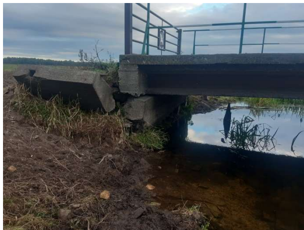
Fot. 105 Odspojone skrzydło przyczółka
