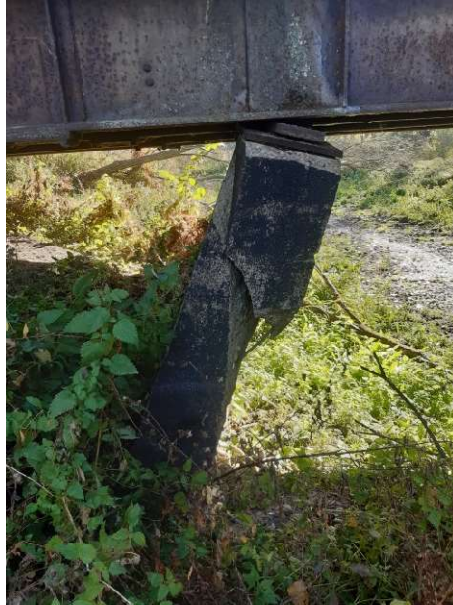
Fot. 134 Uszkodzony filar wraz z łożyskiem
