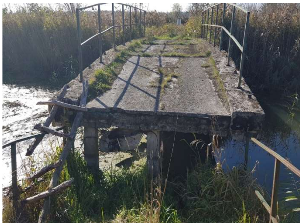
Fot. 143 Most na Starej Warcie z zawalonym przęsłem
