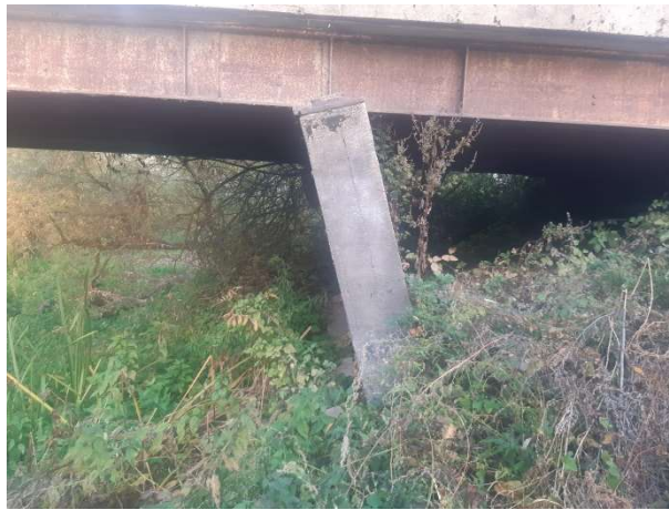
Fot. 112 Uszkodzona filar
