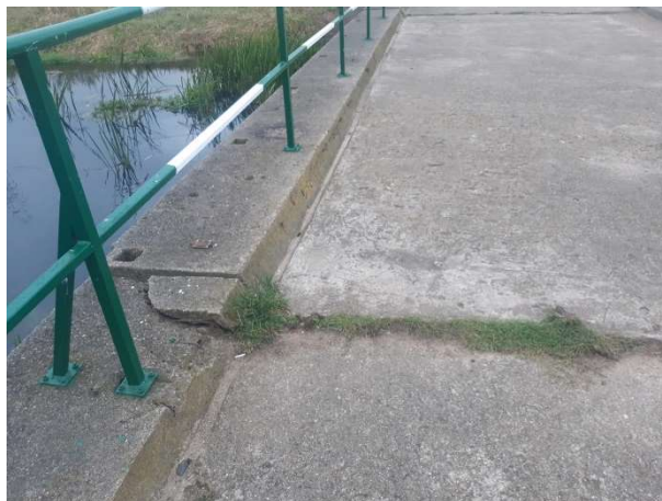
Fot. 108 Uszkodzenie płyty pomostu i kapy chodnikowej
