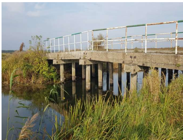
Fot. 146 Most na Starej Warcie z zawalonym przęsłem
