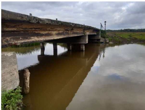
Fot. 62 Odchylenie podpór pośrednich II Most
