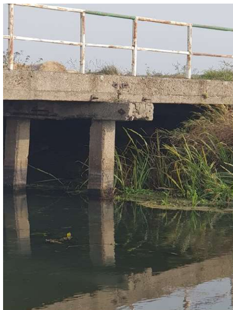
Fot. 147 Skorodowana belka oczepowa
