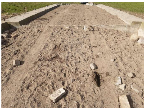
Fot. 166 Nawierzchni jezdni i kapy chodnikowej mostu na drodze numer 21
