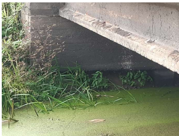
Fot. 117 Widok uszkodzeń belki oczepowej podpory skrajnej
