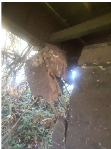
Fot. 115 Uszkodzenie filaru mostu wraz z przesunięciem płyty pomostu
